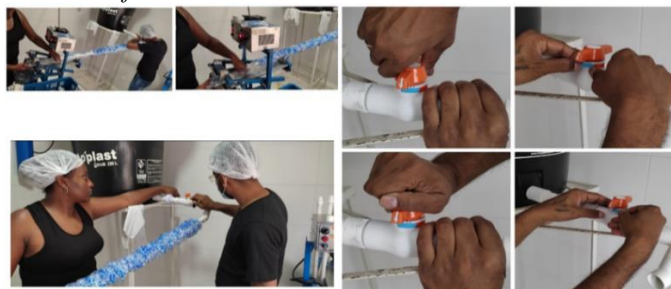
Ilustración 16 foto estudio de la estandarización de la llave del caudal
