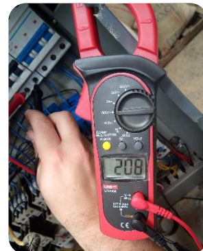
Voltaje medido con voltímetro
