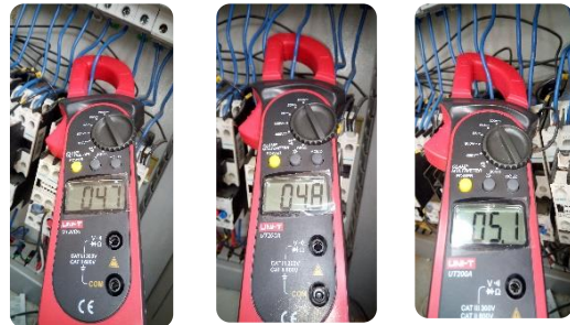
Corriente medida con amperímetro
