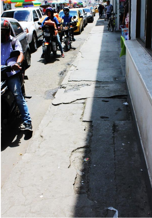
Imagen 22 mal estado de andenes
