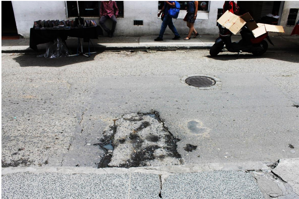
Imagen 24 Mal estado malla vial
