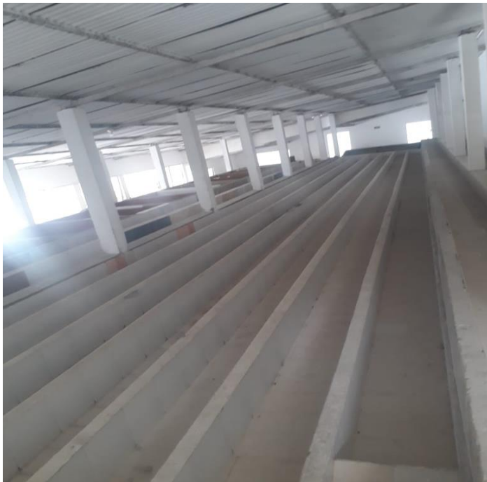
Figura 29. Canales de sedimentación
