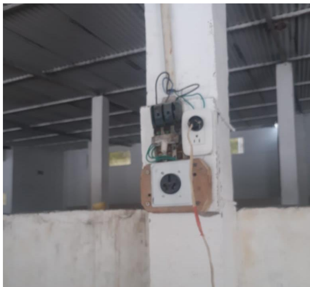
Figura 20. Sistema eléctrico sin protección
