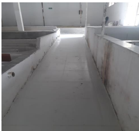
Figura 22. Piso de cerámica deslizante
