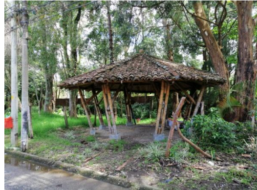
Imagen n° 14 quiosco deteriorado Fuente: autoras
