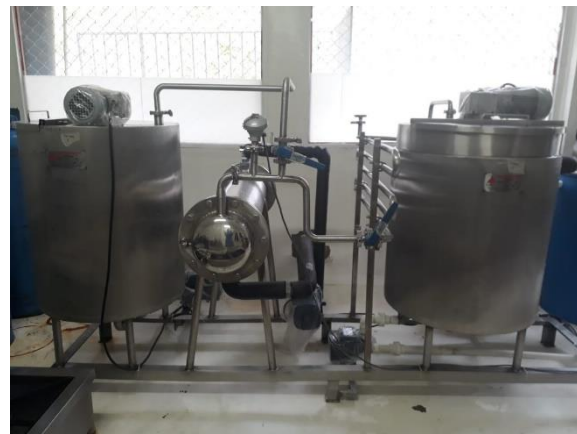
Equipo de pasteurización
