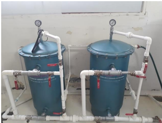
Equipo de filtración de agua
