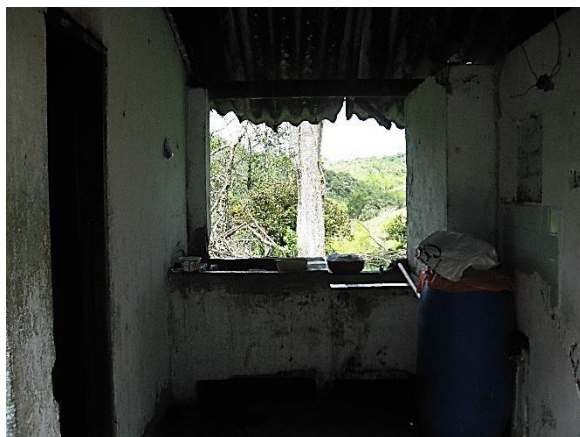
Imagen 112: Lavadero zona de servicios
