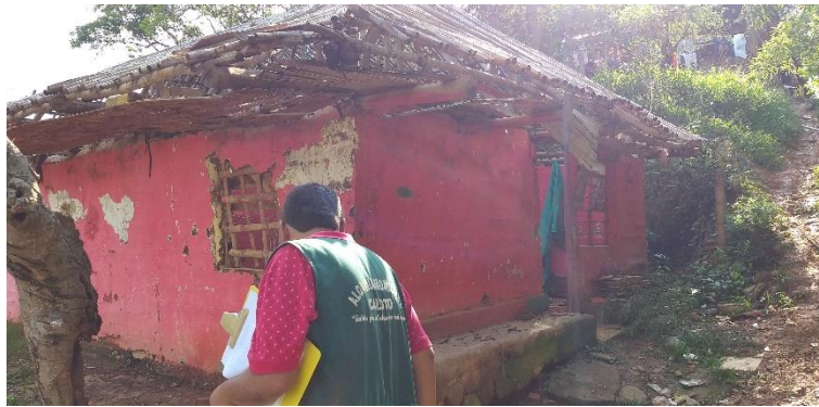
Fotografía 2. Vivienda deshabitada por deterioro estructural.
