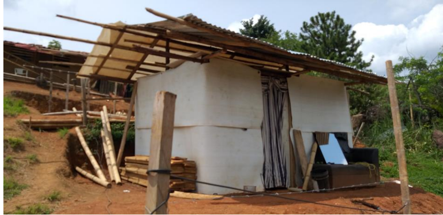
Fotografía 15. Viviendas mal concebidas estructuralmente.
