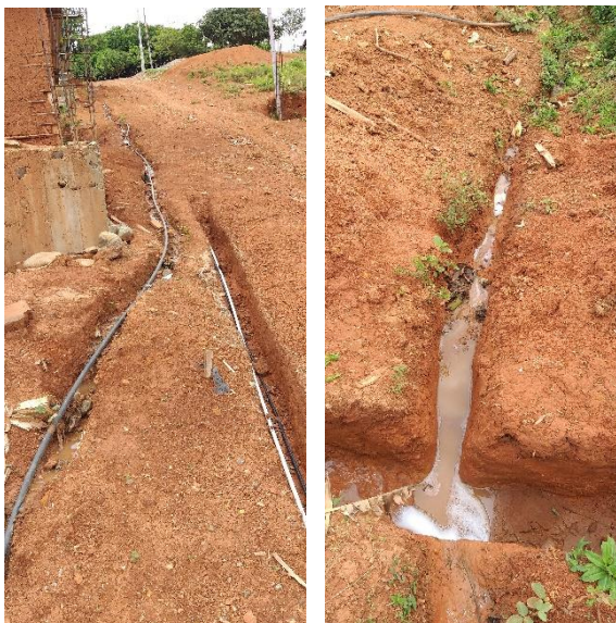
Fotografía 1. Vertimiento de aguas a cielo abierto.
