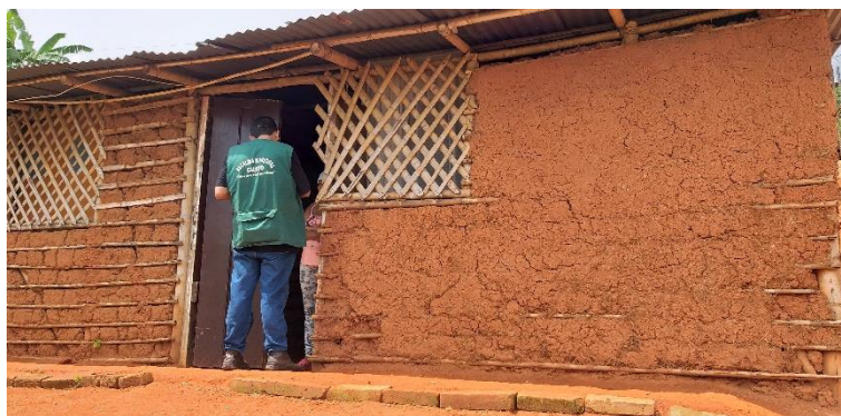
Fotografía 3. Vivienda en condiciones inadecuadas para habitar.
