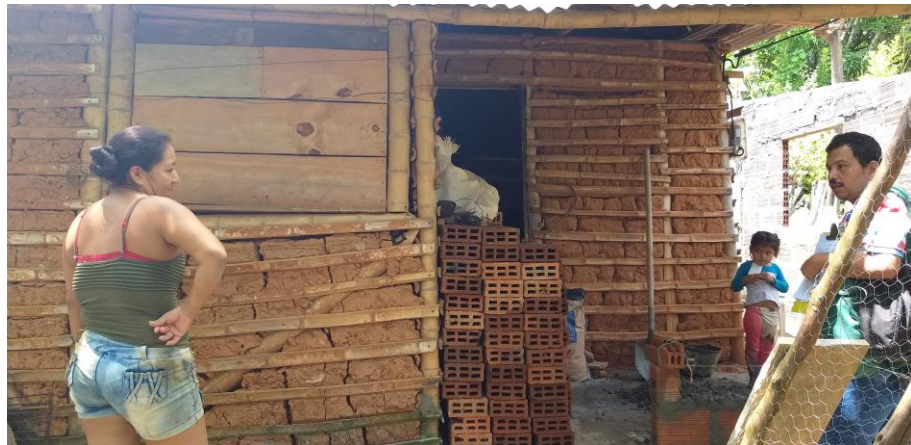
Fotografía 13. Vivienda con deficiencia estructural.
