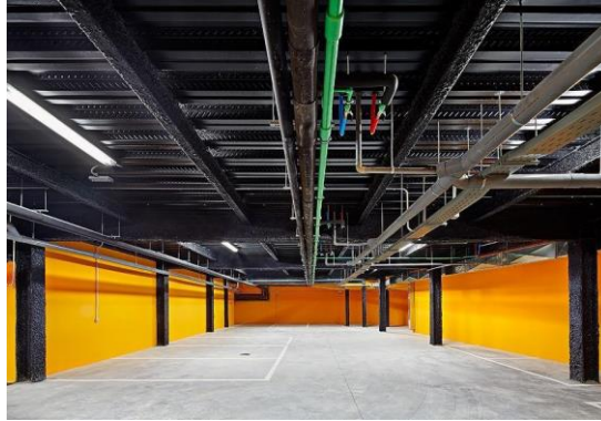
Imagen 13: Sótano, Red Hidráulica, Sanitaria, Red Contra incendios eléctricos
