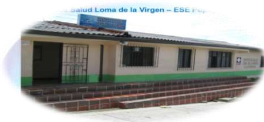
Puesto de salud (foto de hoy se encuentra deteriorado)
