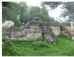
PERDIDA DE PRETILES-MURO DE CONTENCIÓN EN CICLOPEO
