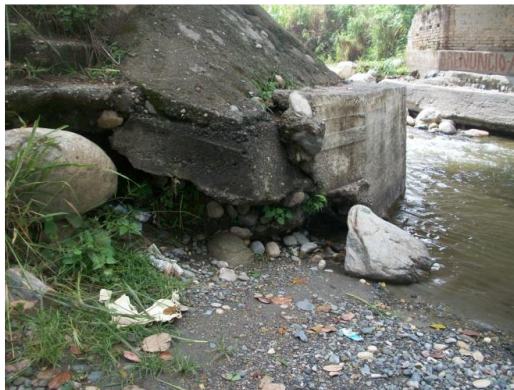
Imagen 5. Socavamiento de su cimentación
