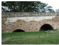
PRESENCIA DE DIFERENTES CLASES DE LADRILLOS
