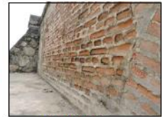
EROSIÓN DE LADRILLO
