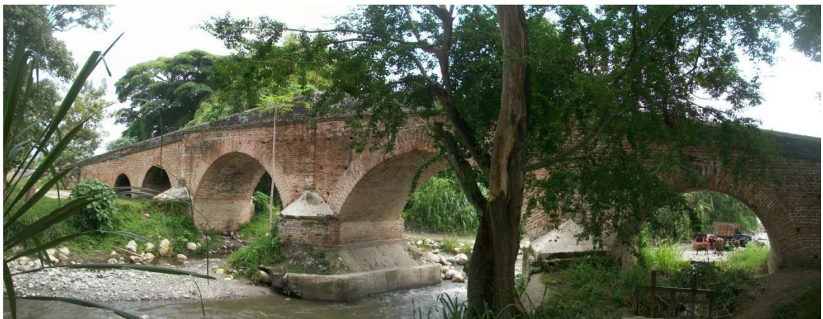
Imagen 2 Puente de Los Esclavos estado actual
