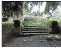
PRESENCIA DE VEGETACIÓN
