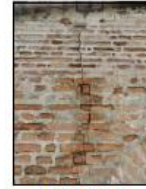
FISURA O AGRIETAMIENTO
