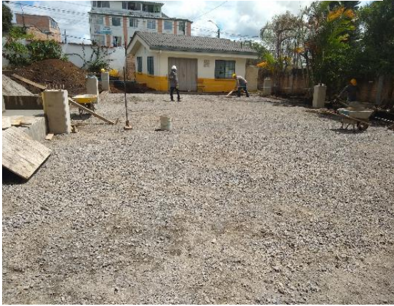
Fotografía 45. Suministro e instalación de base granular como plataforma de placa de concreto.
