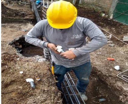
Fotografía 31. Daño de tubería de agua potable
