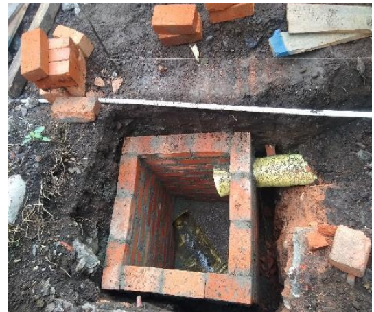
Fotografía 48. Cajas de aguas lluvias
