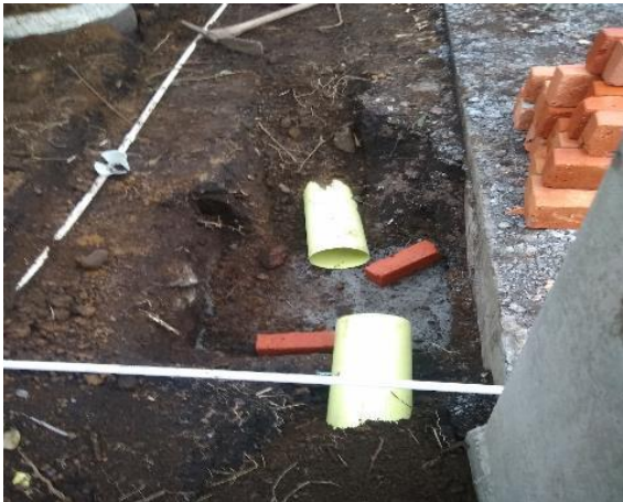
Fotografía 47. Tubería de aguas lluvias
