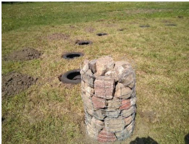
Ilustración 57. Disposición de los basamentos con la ayuda de los estudiantes practicantes, e inicio de anillos internos de la cimentación.
