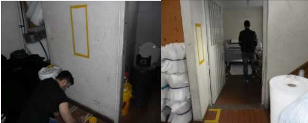
Ilustración 11 Bodega (Demarcación área Extintor)
