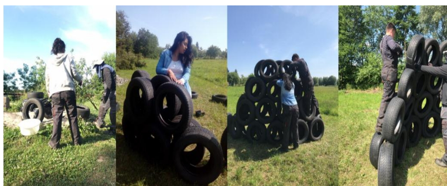
Ilustración 25. Experimento de construcción con neumáticos de modo vertical. A fin de evaluar modulación, peso, filtración de agua, resistencia, tiempo de ejecución y propuesta de revestimiento verde. (Formación de materas en el muro y soporte para la plantación de hiedra). Elaboración propia, 2019.
