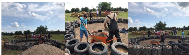
Ilustración 44. Terminación de vaciado de piedra para las bases de maya y vaciado de tierra para las bases de neumático. Elaboración propia, 2019.
