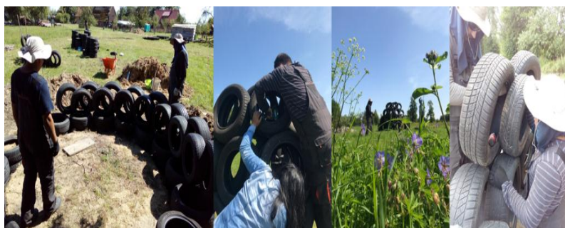
Ilustración 31. Construcción de muro, la disposición implementada en la base del muro prevalece hasta la terminación de este. Elaboración propia, 2019.
