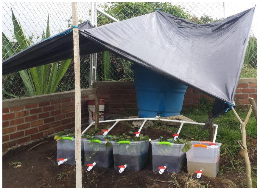
Figura 13. Sistema a escala piloto instalado
