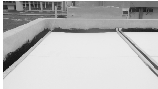
Imagen 11 Sistema de Climatización Natural con techo estanque.
