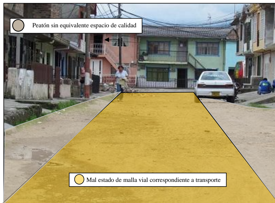
Ilustración 20: malla vial en mal estado
