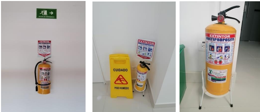
Figura 14 Protección contra incendios
