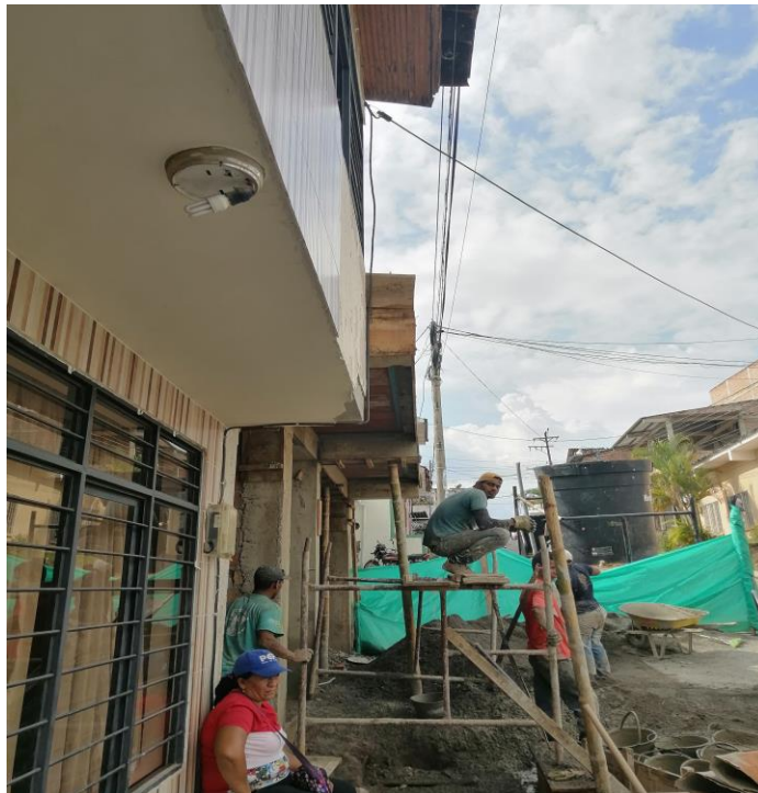
Imagen 12. Visita realizada, detencion de la obra
