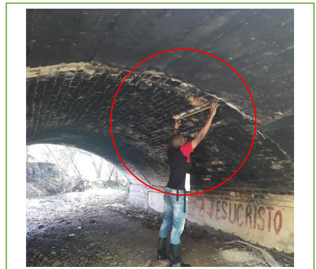
Figura 23 Fuente propia: toma de fracturas internas
