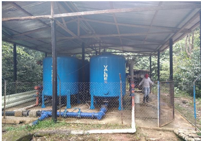
Foto 5. Planta de tratamiento
