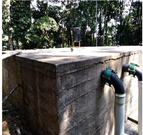
FOTO 23. Tanque de almacenamiento
