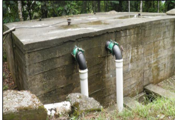
Foto 6. Tanque de almacenamiento
