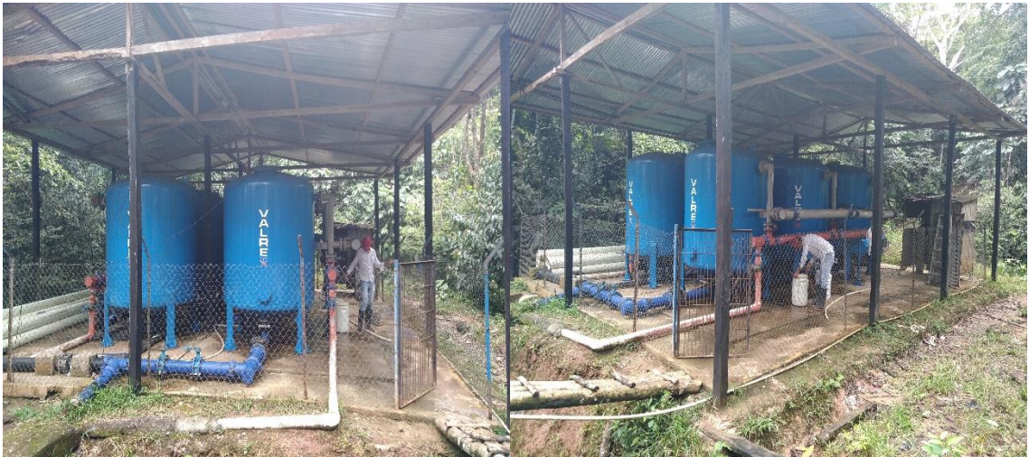
FOTO 21. Planta de tratamiento
