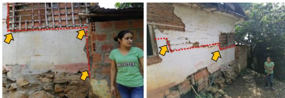
Imagen N°32 -Evidencia fotográfica-informe N°47 del 2020 - archivo de oficina de gestión del riesgo.
