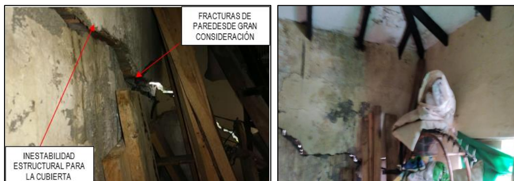
Imagen N°31 -Evidencia fotográfica-informe N°107 del 2020 - archivo de oficina de gestión del riesgo.
