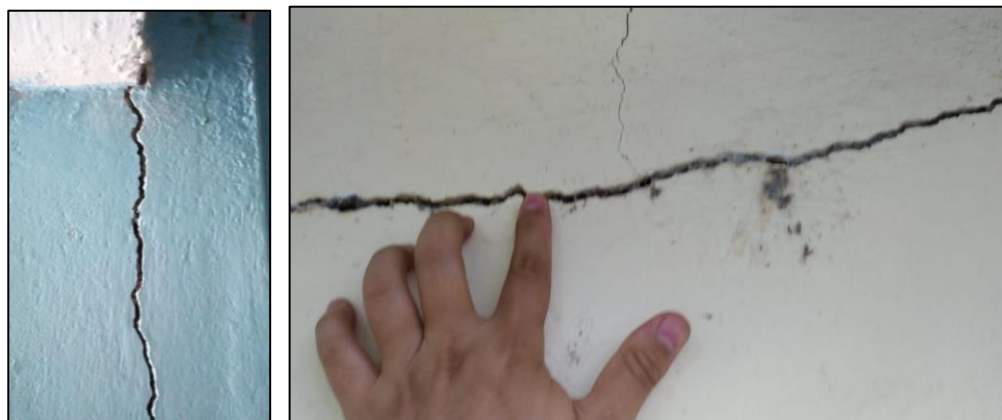
Imagen N°30 -Evidencia fotográfica-informe N°12 del 2020 - archivo de oficina de gestión del riesgo.
