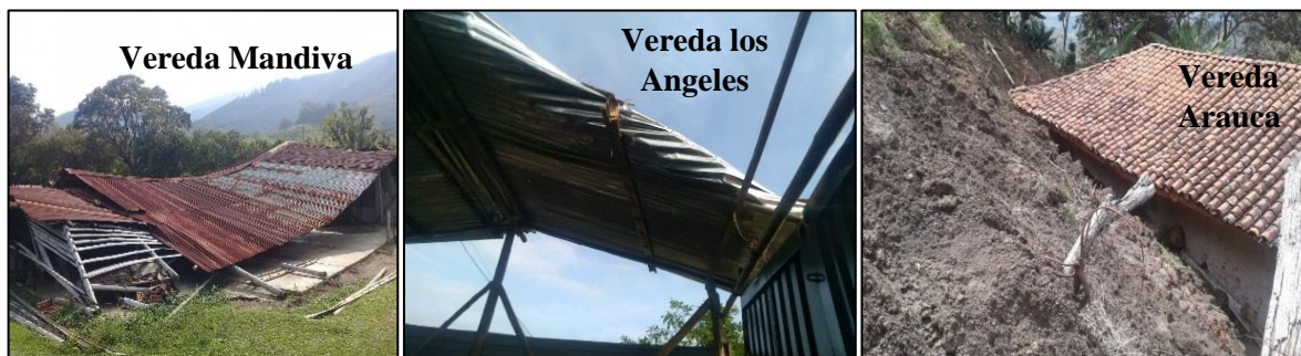
Imagen N° 2. Daños causados por el vendaval de Marzo 03 del 2020, en diferentes veredas del Municipio, donde se muestra pérdidas parciales y completas en cubierta y destrucción de la vivienda consecuencias por la remoción en Masa. Fuente: Autor.
