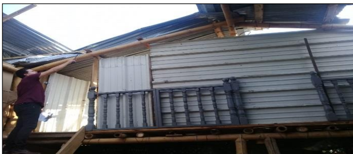
Imagen N°4. Daños en Cubierta causado por vendaval del 3 de marzo 2020 en la Zona Rural del Municipio de Santander de Quilichao. Vereda los Ángeles. Fuente: Registro fotográfico del Autor.
