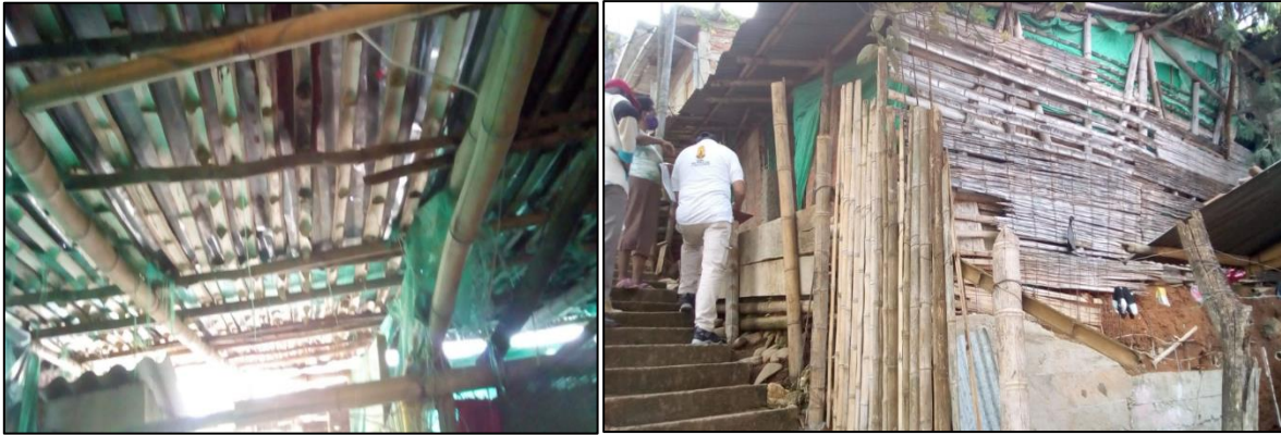
Imagen N°45-Evidencia fotográfica de solicitud de amarras para cubierta Informe N°201 del 5 de noviembre del 2020
