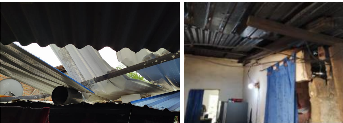
Imagen N°29 -Evidencia fotográfica-informe N°76 del 2019 - archivo de oficina de gestión del riesgo.
