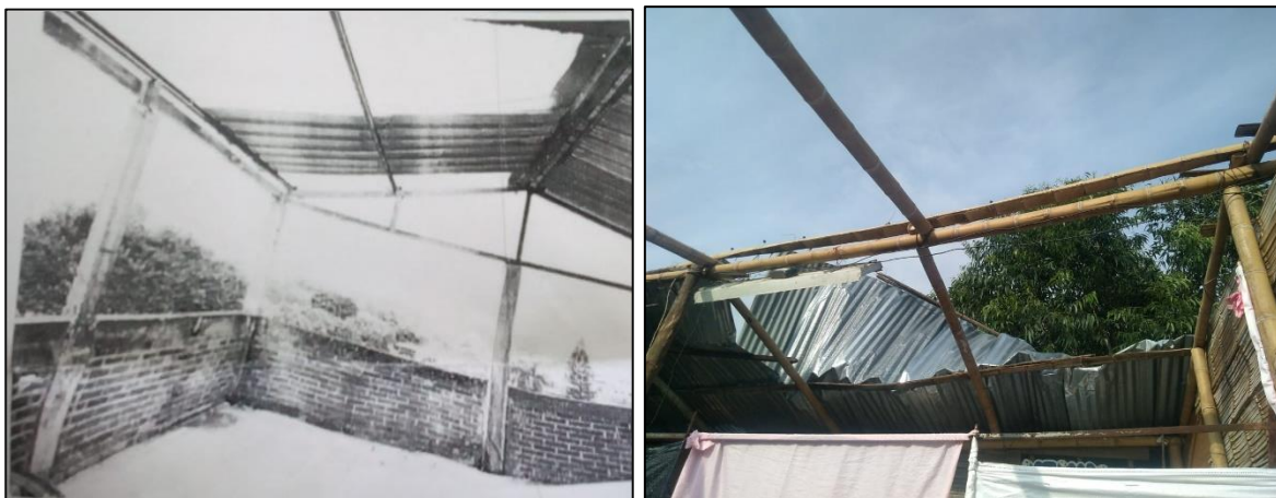
Imagen N°41-Evidencia fotográfica de vivienda anteriormente afectada por un vendaval Informe N°86 del 28 de noviembre del 2019
