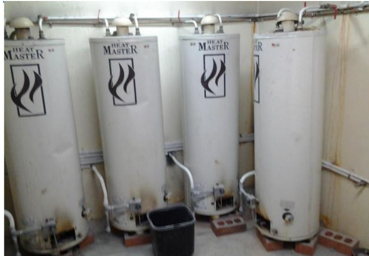
Imagen 23. Calentadores de agua con Gas natural
