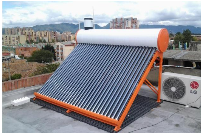
Imagen 22. Panel solar para calentamiento de agua
