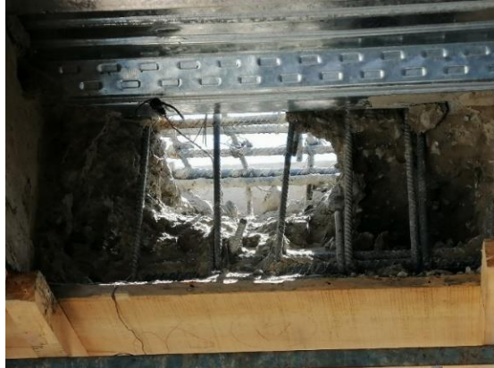
Foto 27. Evidencia de la falta de pegante del concreto en el hierro (22/08/19)
