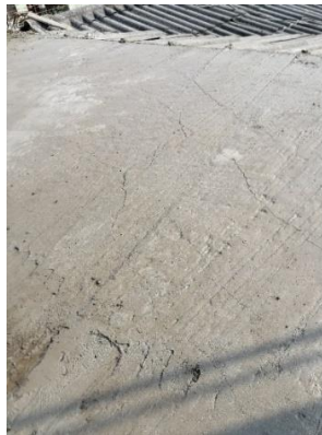
Foto 23. Fisuras de losa segundo piso (15/08/19)
