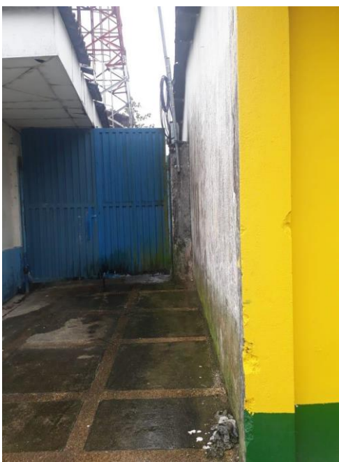
Imagen 10. Humedad en el muro.
