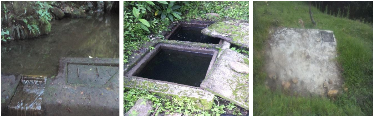
Imagen 2. Sistema de infraestructura de la quebrada Palestina; Bocatoma, tanque desarenador, tanque de almacenamiento. Elaboración propia.
