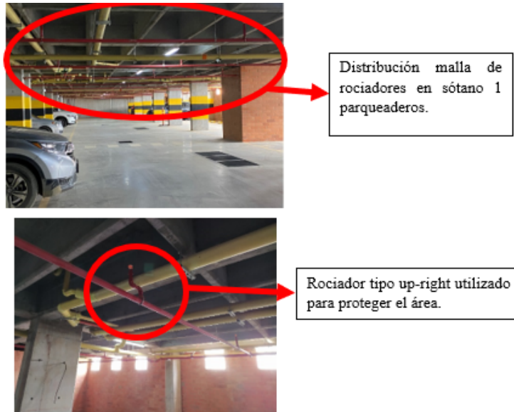
Figura 22. Malla de rociadores conjunto residencial.
