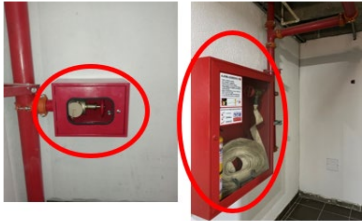
Figura 24. Gabinete de mangueras contra incendios clase 1 y clase 2
