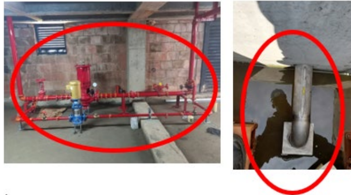
Figura 20. Estación de bombeo
