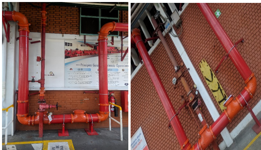
Figura 27. Riser y estaciones de control para las subáreas de la planta.
