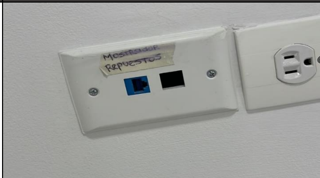
Img tomacorrientes y conexión datos.
