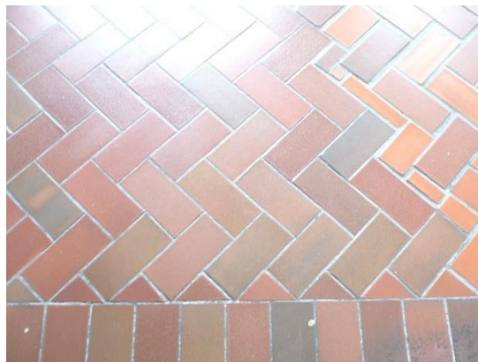
Figura 98. Foto del tipo de piso NO adecuado en edificio #5 (Fuente: elaboración propia, 2018)
