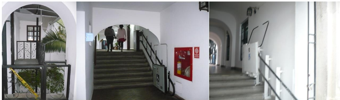
Figura 94. Fotos de elevador y plataformas averiadas (Fuente: elaboración propia, 2018)
