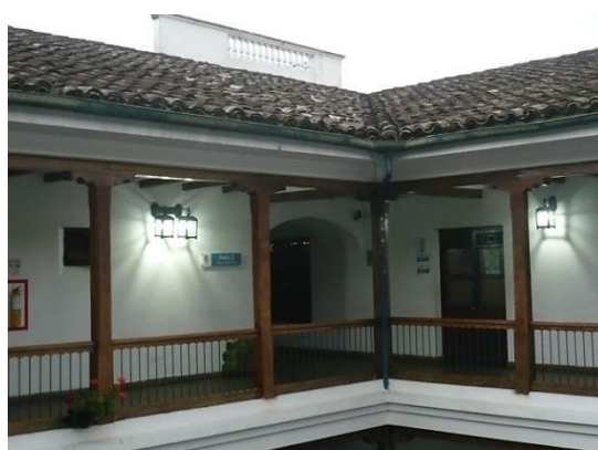
Figura 99. Foto del tipo de barandas NO adecuados en edificio #2 (Fuente: elaboración propia, 2018)
