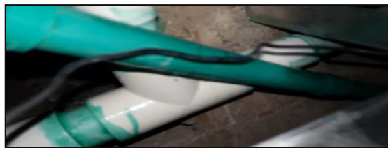
Ilustración # 64. Tubería con gotera
