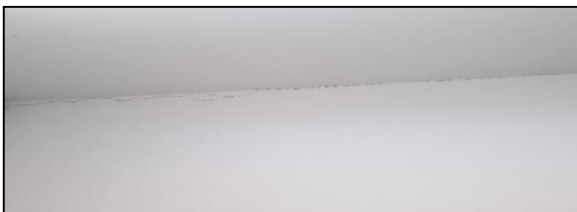
Ilustración #135. Fisura en dilataciones
