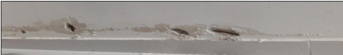
Ilustración # 93. Humedad en guarda escoba
