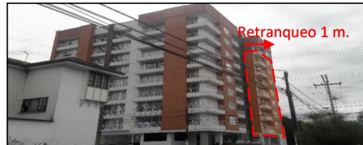
Ilustración #136. Fachada con problema de fisura
