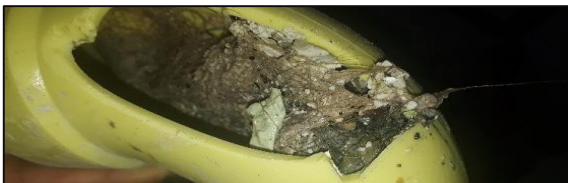
Ilustración #156. Se rompe codo tapado
