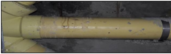
Ilustración # 14. Tuberías despegadas
