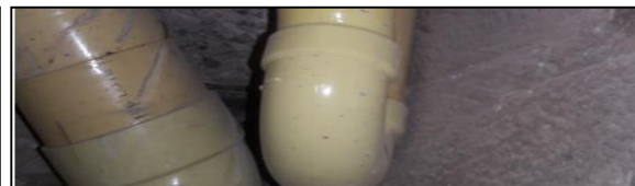
Ilustración #159. Arreglo de tubería
