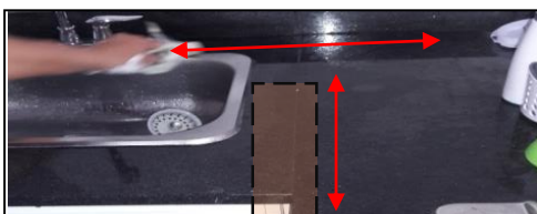
Ilustración # 75. Juntas con filtración
