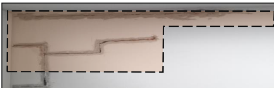
Ilustración #137. Fisura en paredes
