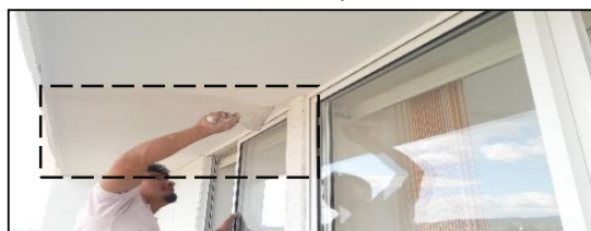
Ilustración #146. Fisura superior
