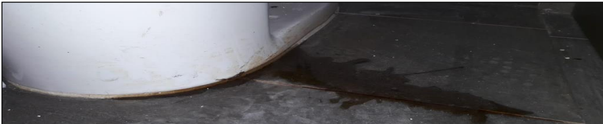
Ilustración # 90. Filtración agua negra
