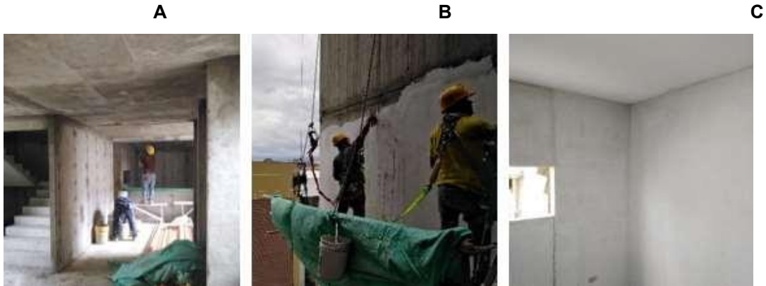
Imagen 31. 31A. Zona Común., 31B. Relleno Fachada, 31C. Estuco Apartamento.
