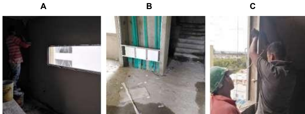
Imagen 39. 39A. Estuco Aptos., 39B. Braker Zona Común, 39C. Cartera Grada Ppal.
